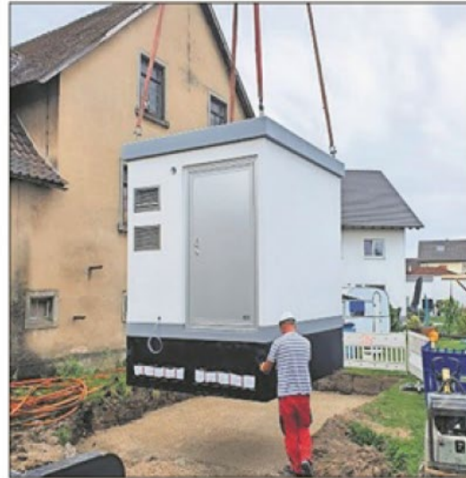
Das Herzstück des Breitbandausbaus in Unzhurst: das Verteilergebäude in der Acherner Straße.
