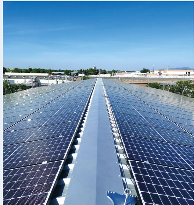
Solarmodule, soweit das Auge reicht: Schwarzwald Eisen erzeugt und verbraucht grünen Strom vom eigenen Dach.
