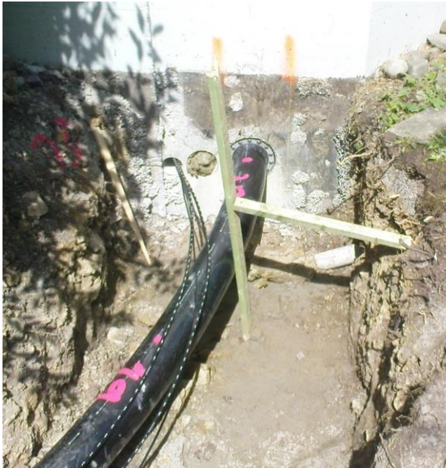
Hausanschlussleitung und Hauseinführung
